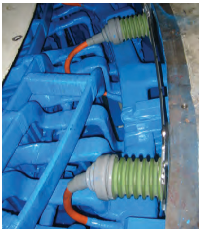
Acopladores capacitivos instalados em um estator de um hidro-gerador
