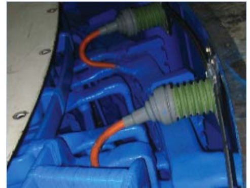
水力発電機内に取り付けた PDAカプラー
