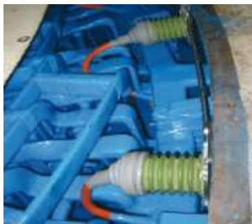
Acopladores instalados en el estator de un hidrogenerador
